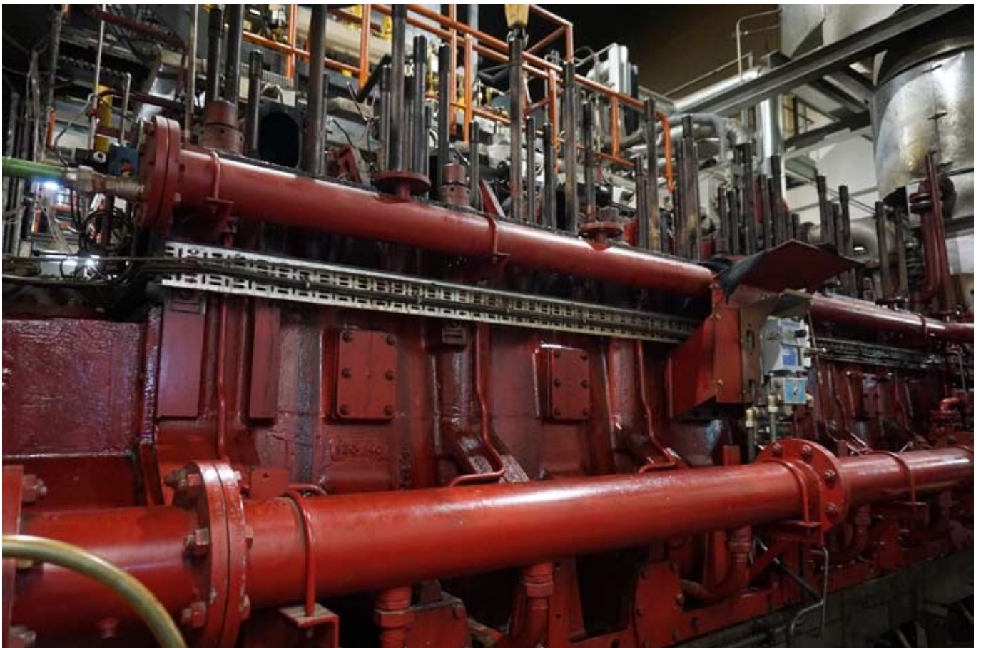
Dieselgroßaggregat, historisches Exponat vor der Demontage, Stadtwerke Zittau.
